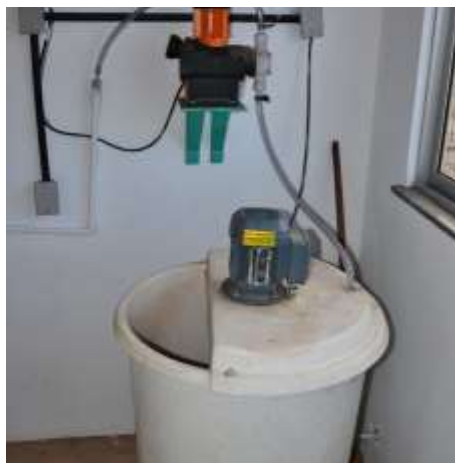
Figura 88. Tanque de Preparo de Produto Químico
