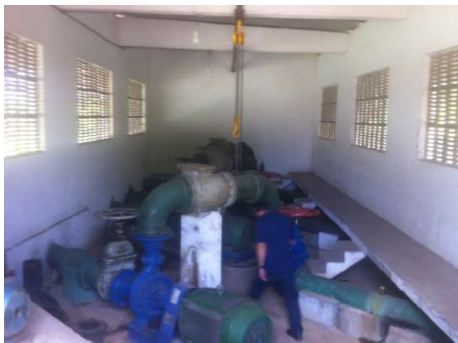
Figura 46. ETA Volta Redonda para R4 Fonte: ASCOM SAAE/Caxias, 2015.
