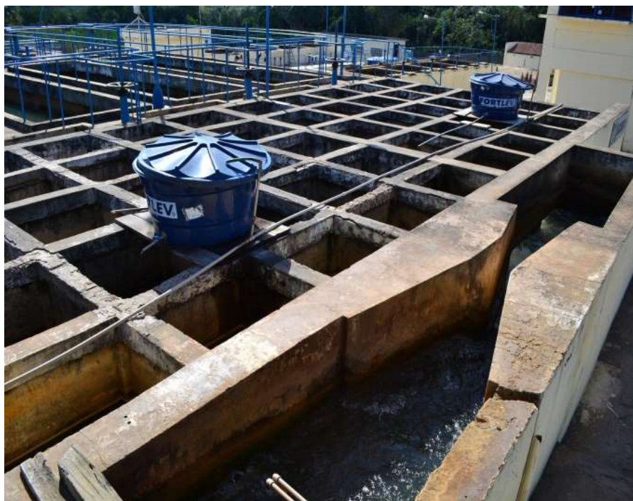
Figura 15. ETA V. Redonda 1 - Calha Parshall e Floculadores Fonte: ASCOM SAAE/Caxias, 2015.
