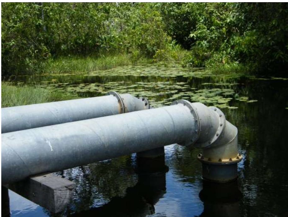
Figura 26. Tubulações de Sucção da EEAB
