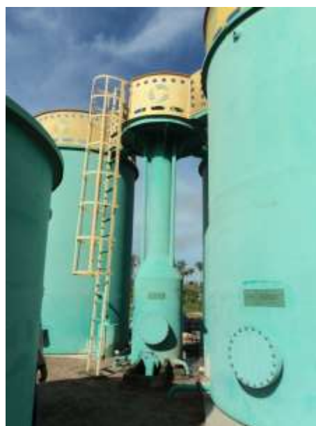
Foto 4 - Detalhe desarenador cônico vertical posterior à EEE
