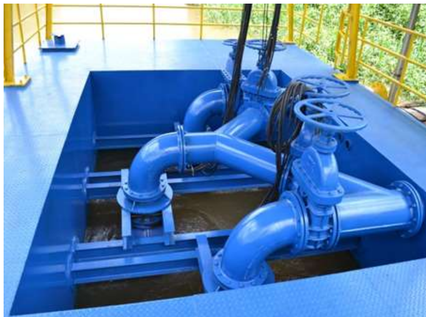
Figura 10. Barrilete de Recalque
