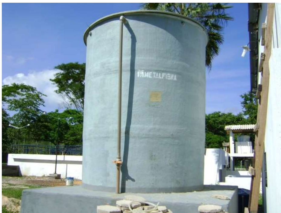
Figura 32. Tanques de Produtos Químicos Fonte: ASCOM SAAE/Caxias, 2015.
