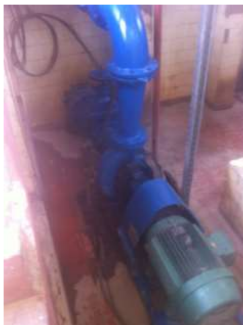
Figura 47. ETA Volta Redonda para R5 Fonte: ASCOM SAAE/Caxias, 2015.
