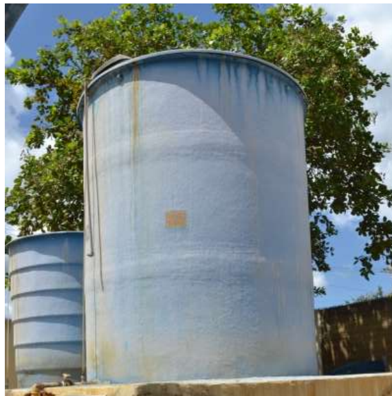
Figura 21. Tanques de Produtos Químicos Fonte: ASCOM SAAE/Caxias, 2015.
