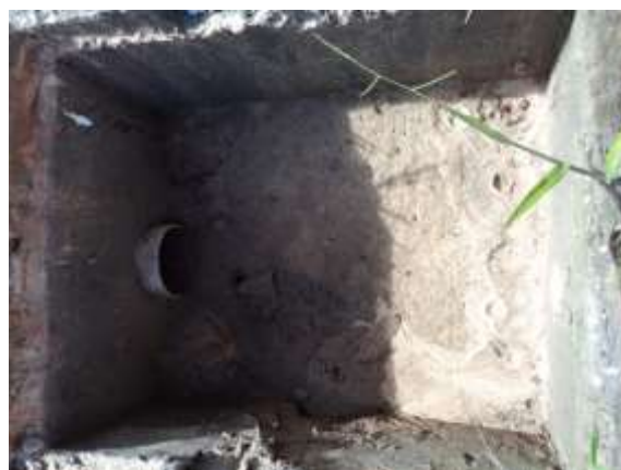
Foto 2 ☐ Areia sedimentada nas caixas de inspeção
