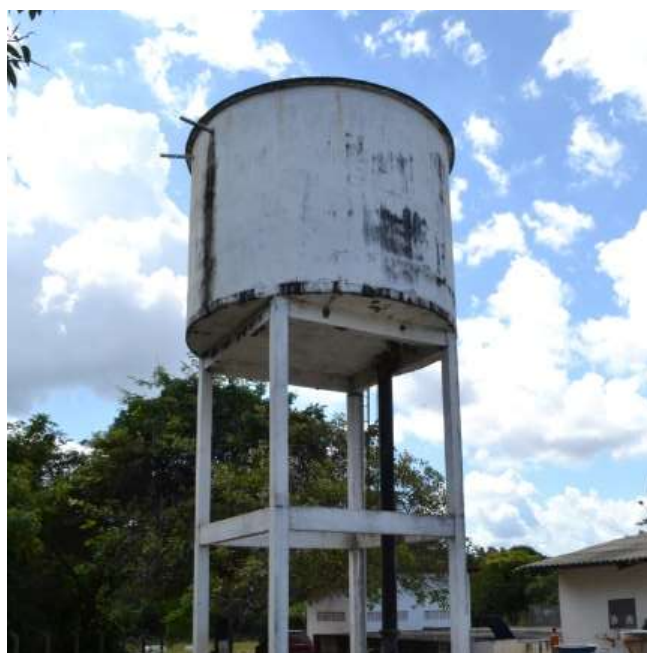
Figura 35. Reservatório de Água de Retrolavagem
