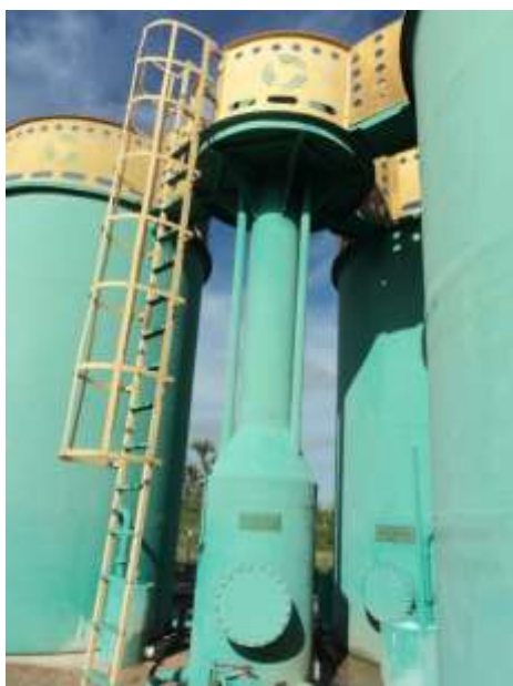
Foto 3 - Detalhe desarenador cônico vertical posterior à EEE
