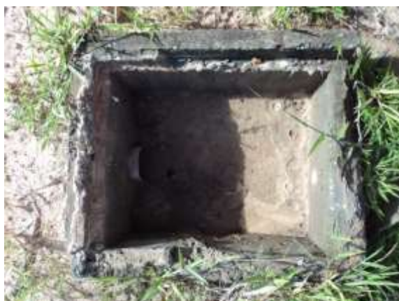
Foto 1 ☐ Areia sedimentada nas caixas de inspeção
