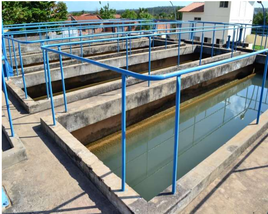
Figura 16. ETA V. Redonda 1 □ Decantadores
