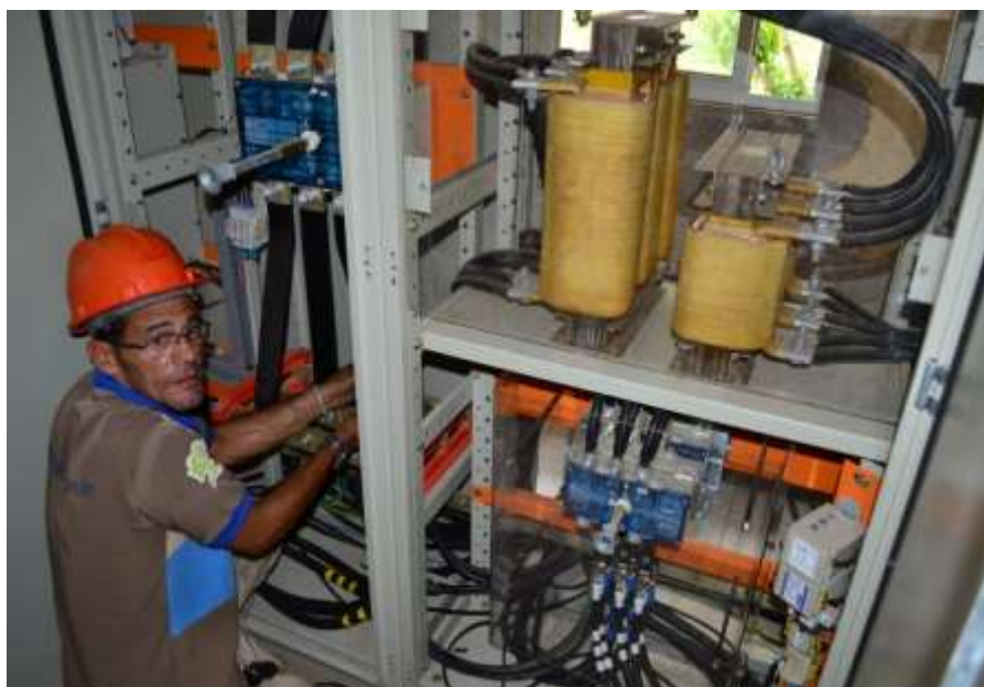
Figura 12. Painéis de Comando das Bombas
