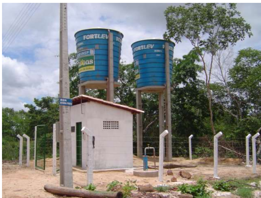
Figura 51. Poço Brejinho Fonte: ASCOM SAAE/Caxias, 2015.
