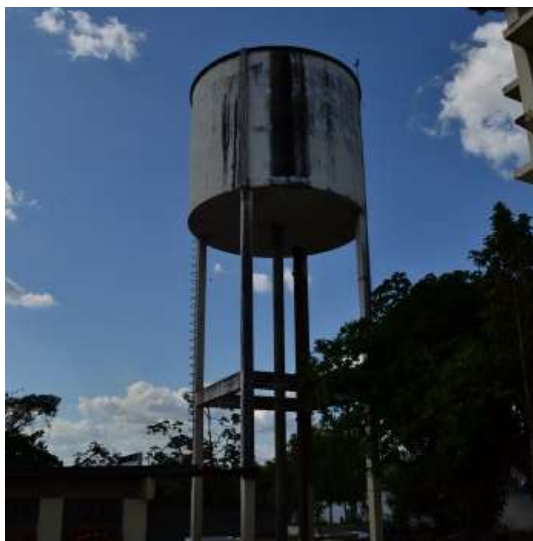
Figura 18. ETA V. Redonda 1 - Reservatório de Lavagem dos Filtros Fonte: ASCOM SAAE/Caxias, 2015.
