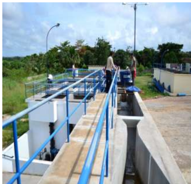
Figura 19. ETA Volta Redonda 2 - Calha Parshall Fonte: ASCOM SAAE/Caxias, 2015.
