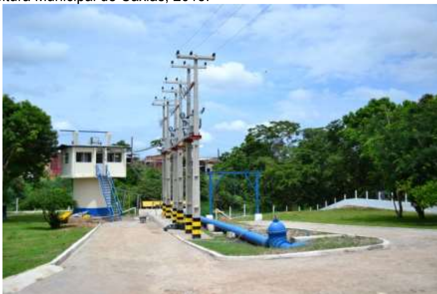
Figura 11. Transformadores e Casa de Comando
