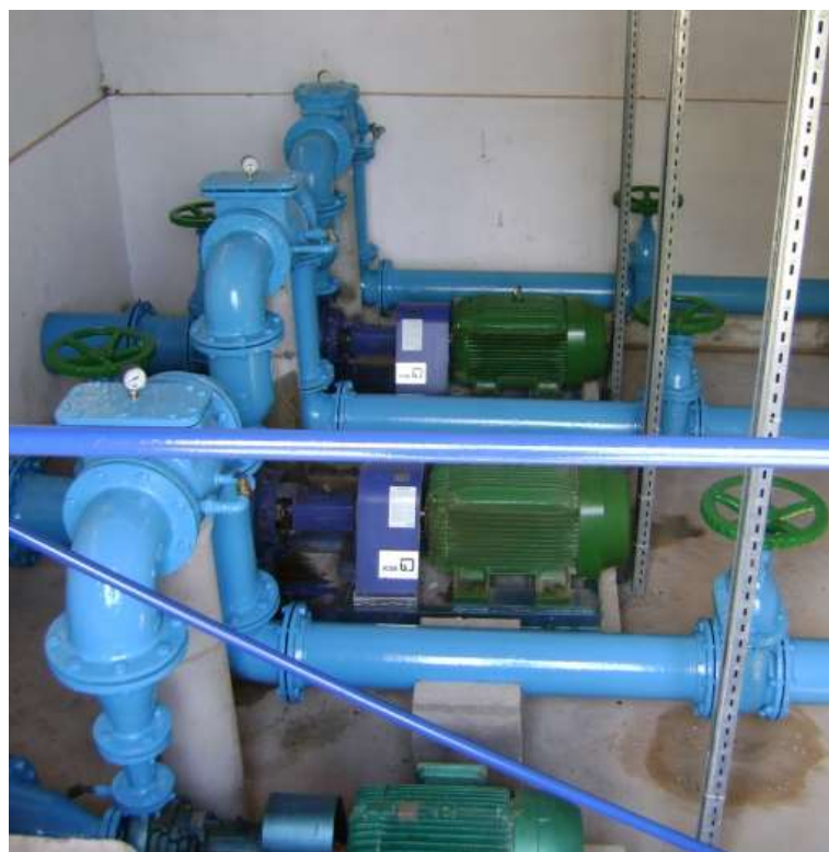
Figura 48. ETA Ponte para rede de distribuição Fonte: ASCOM SAAE/Caxias, 2015.
