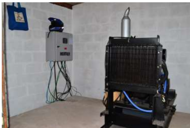
Figura 89. Grupo gerador de energia elétrica
