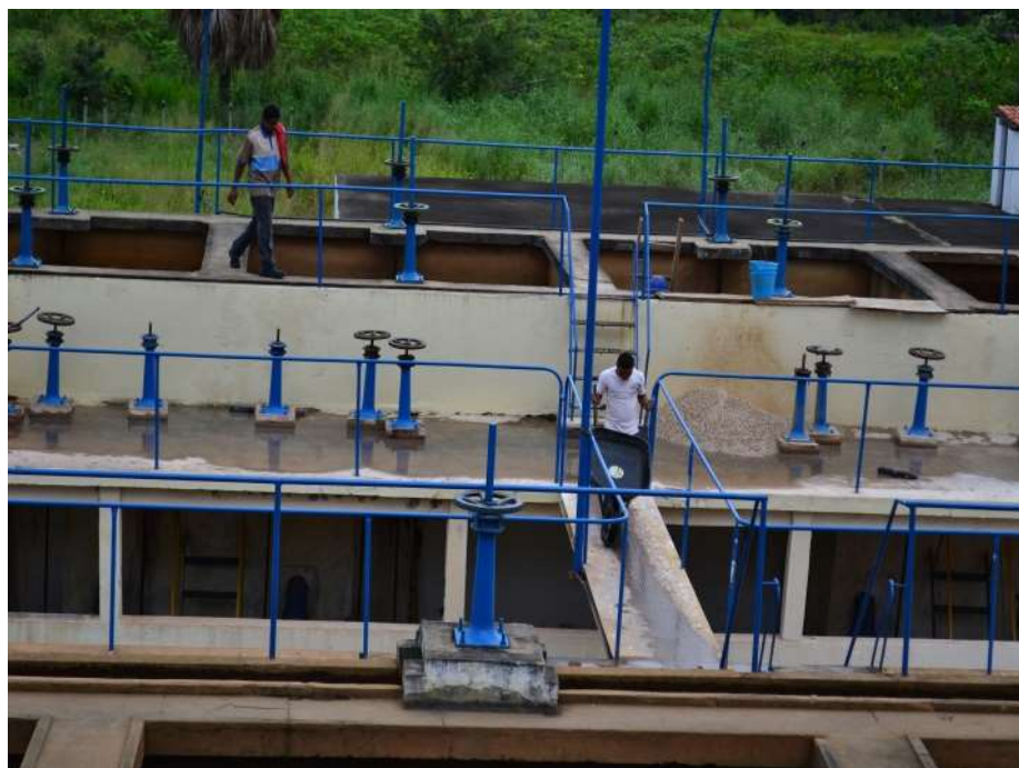
Figura 17. ETA Volta Redonda 1 □ Filtros
